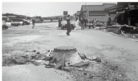
地盤沈下してマンホールが30センチほど浮き上がっている道路。
